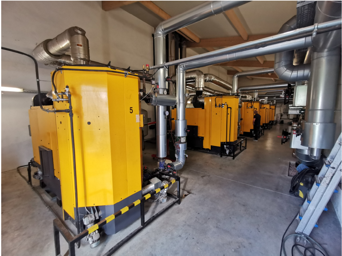
Abbildung 3: Hackgut-Kesselkaskade bestehend aus fünf ETA-Hack 350
